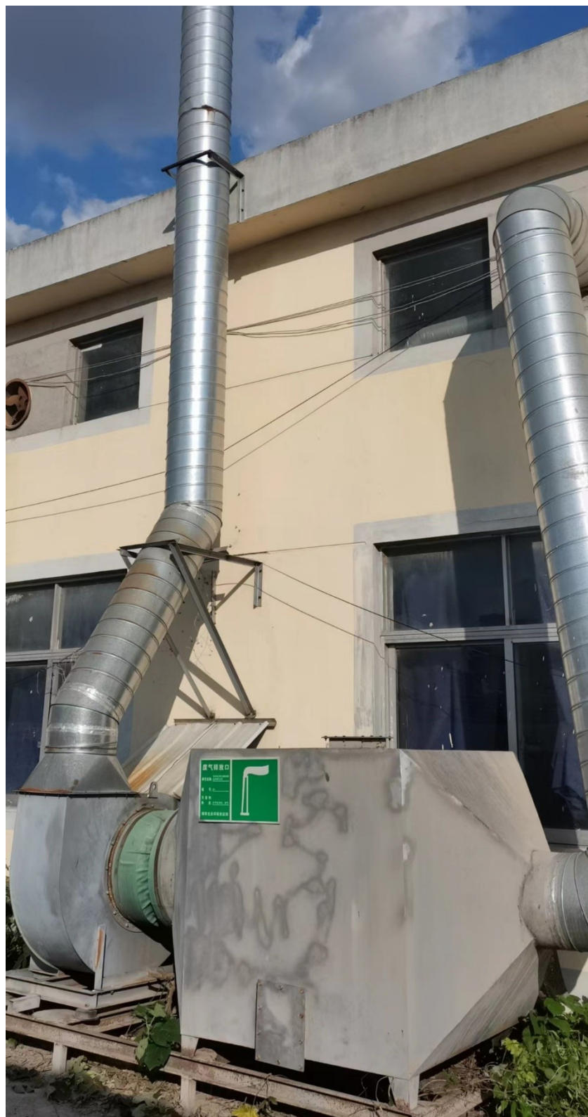
图 3-4 废气排放口图
